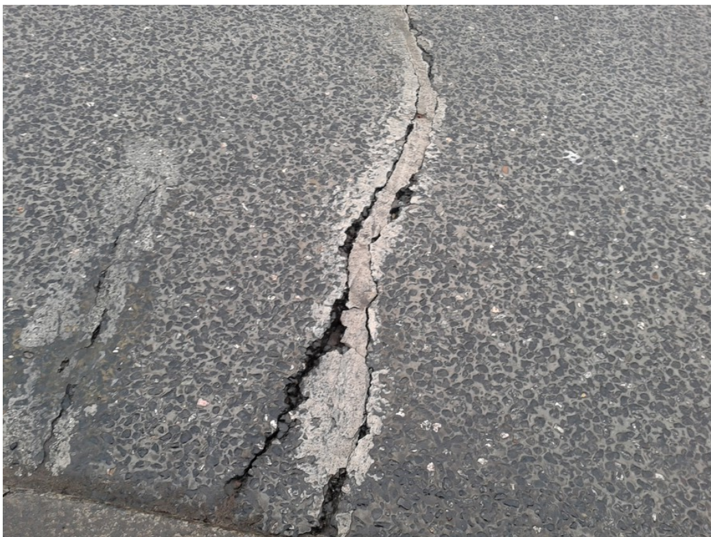
Fot. 8-9 Porównanie części spękania drugiego do stanu poprzedniego
