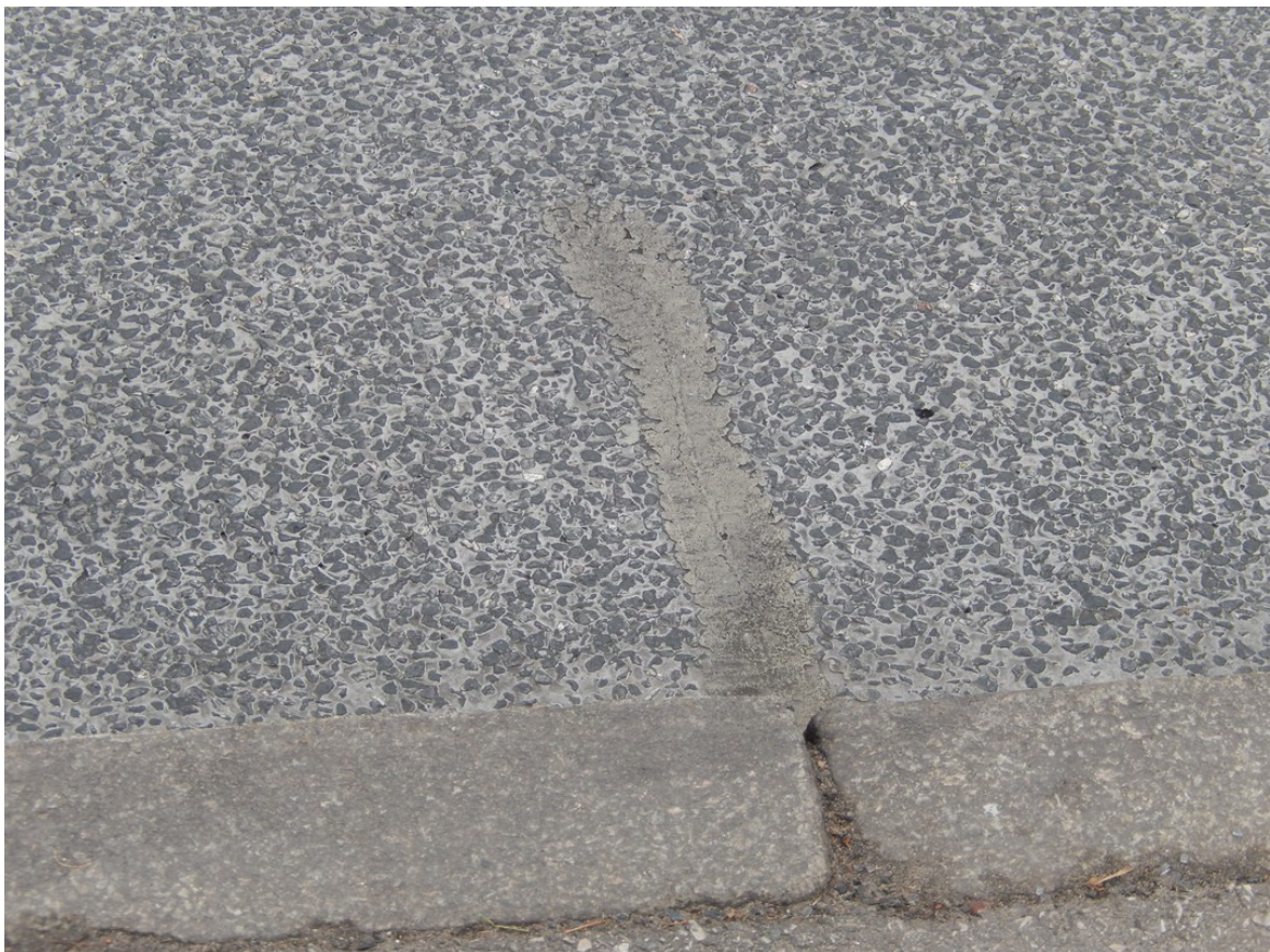
Fot. 2 Spękanie poprzeczne trzecie
