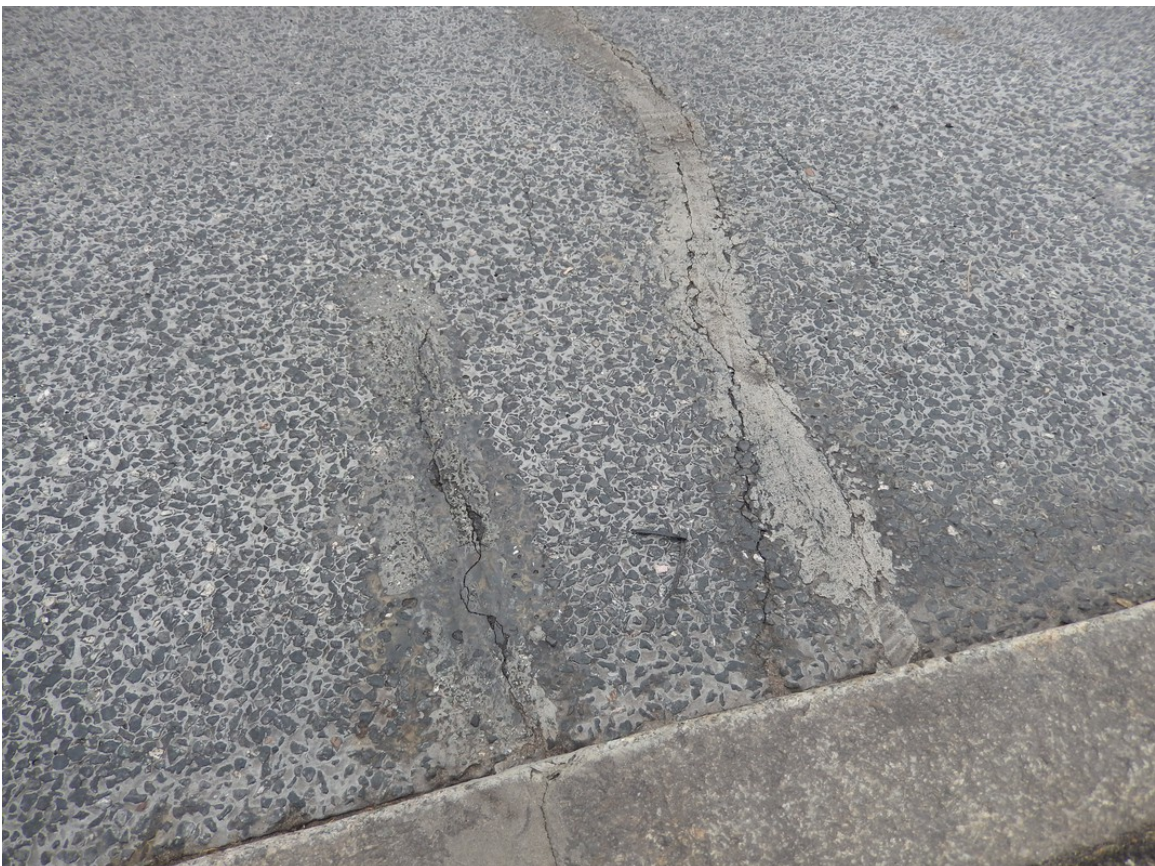
Fot. 4 Spękanie poprzeczne drugie – bliższa część
