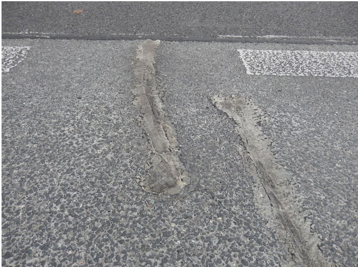
Fot. 6 Spękanie poprzeczne drugie – dalsza część
