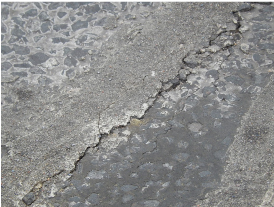
Fot. 7 Zbliżenie zaprawy pokrywającej spękanie
